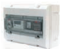
panele elektryczne z elektronicznym sterownikiem wilgotności
